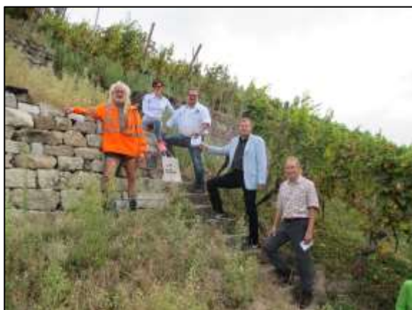
Abbildung 12: Die Sanierung der Trockenmauer von Familie Meier/Susenburger ist abgeschlossen. H. Hildner (2. Vors.) übergibt die Plakette. Foto: Stadt Baden-Baden/OV Rebland.
